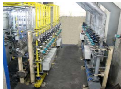
Umfangreiche Regelungstechnik für zuverlässige Regelgüte
